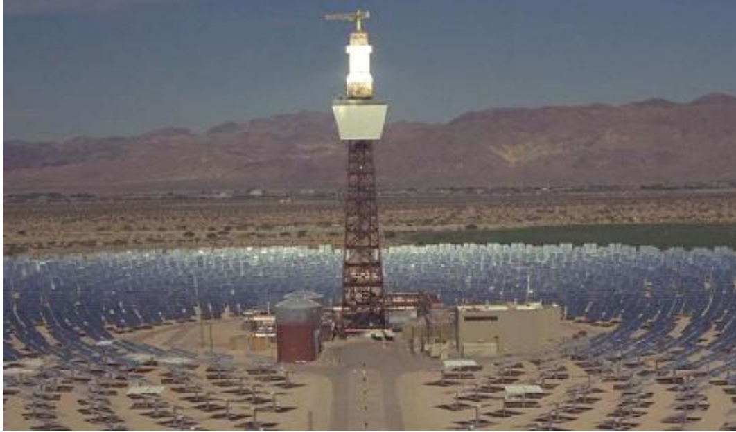
الشكل (15.4) صورة فوتوغرافية لمحطة توليد كهربائية تستخدم نظام المستقبل المركز.
