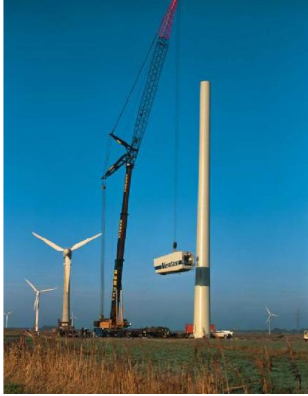
الشكل (2.5) توربين ريحي ينتج 1.5 MW عام 1996
